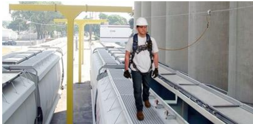
ภาพที่ 3-3 การติดตั้งสายช่วยชีวิตแนวนอนระหว่างจุดยึดเกี่ยวตลอดพื้นที่ปฏิบัติงาน และ ผู้ปฏิบัติงานต้องสวมใส่อุปกรณ์คุ้มครองความปลอดภัยจากการตกจากที่สูงตลอดระยะเวลาการปฏิบัติงาน
